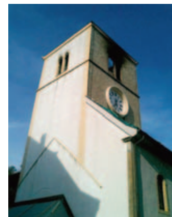
Le clocher a été endommagé par l'incendie. BASILE WEBER
